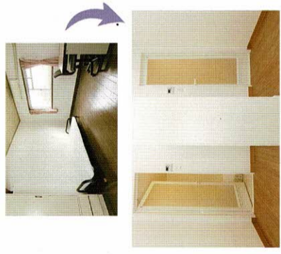
大タイプの居室を2つのバスルームと広々とした脱衣スペースにリフォーム。
